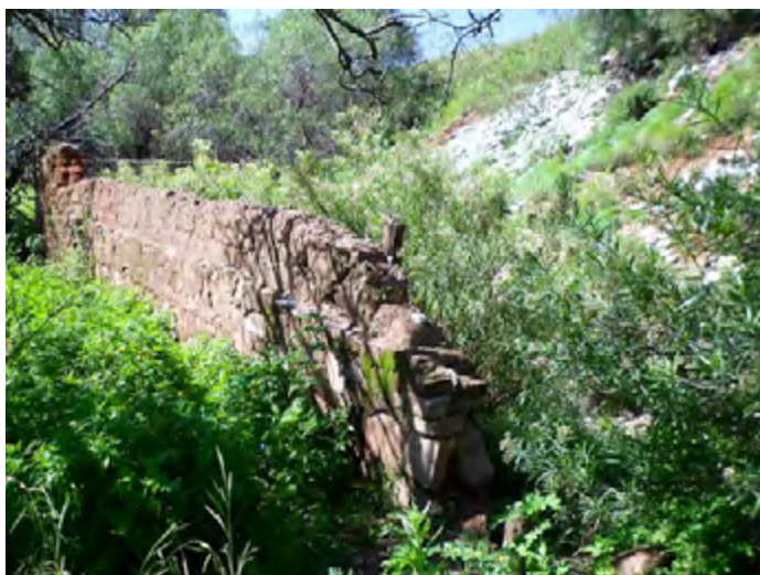
Figura 3: Muro donde se observan los materiales asociados a la primera fase y que corresponde a la mayor parte del muro perimetral, así como algunos de los muros que separan las unidades de trabajo.
