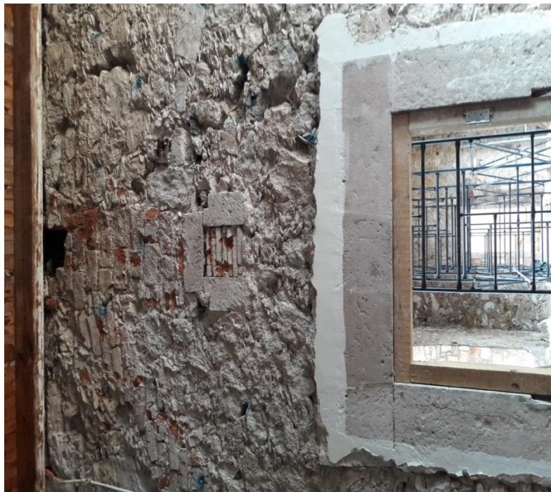
Figura 8. Se han removido los recubrimientos de dicho muro y se evidencia claramente en la parte superior del acceso la disposición de lo que alguna vez fue parte del sistema de chimeneas (fotografía tomada por Jorge Eduardo Ortiz Marcial, Octubre 2017).
