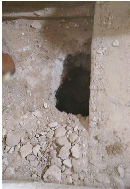
Figura 23. Colapso de una sección del estrato al nivel de las vigas, el cual correspondía a un relleno de tierra y piedra, esto fue muy común durante el desarrollo de este trabajo de excavación. Fotografió Alberto Peña
