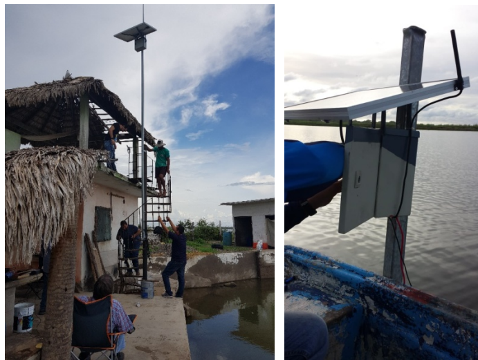
Figura 12. Instalación de los dispositivos del sistema en tierra (izquierda) y en el estanque acuícola (derecha).
