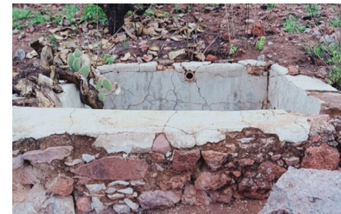
Figura 2: pileta asociada al cerro donde se puede ver que ha sido sometida a mantenimiento y en la parte superior también destaca la tubería de arcilla
