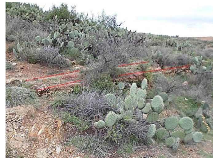
Figura 4: Vista del deterioro de la acequia.
